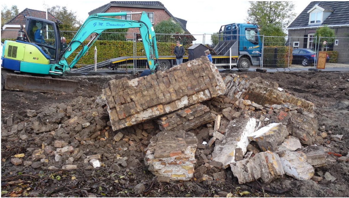
Afb. 17 Stukken van de fundering op een hoop. Bij het stuk bovenop kijken we tegen de eerste gemetselde laag van de fundering. Daaronder lag nog een vlijaag van losliggende stenen. Foto richting N.
